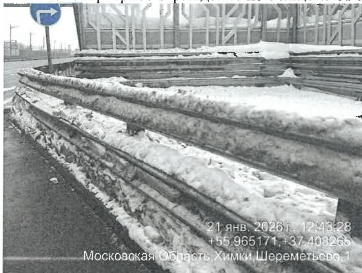
12. Барьерное ограждение не очищено от снега и наледи.
