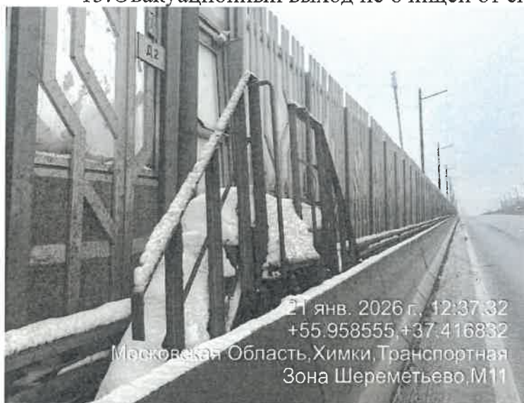
13. Эвакуационный выход не очищен от снега.
