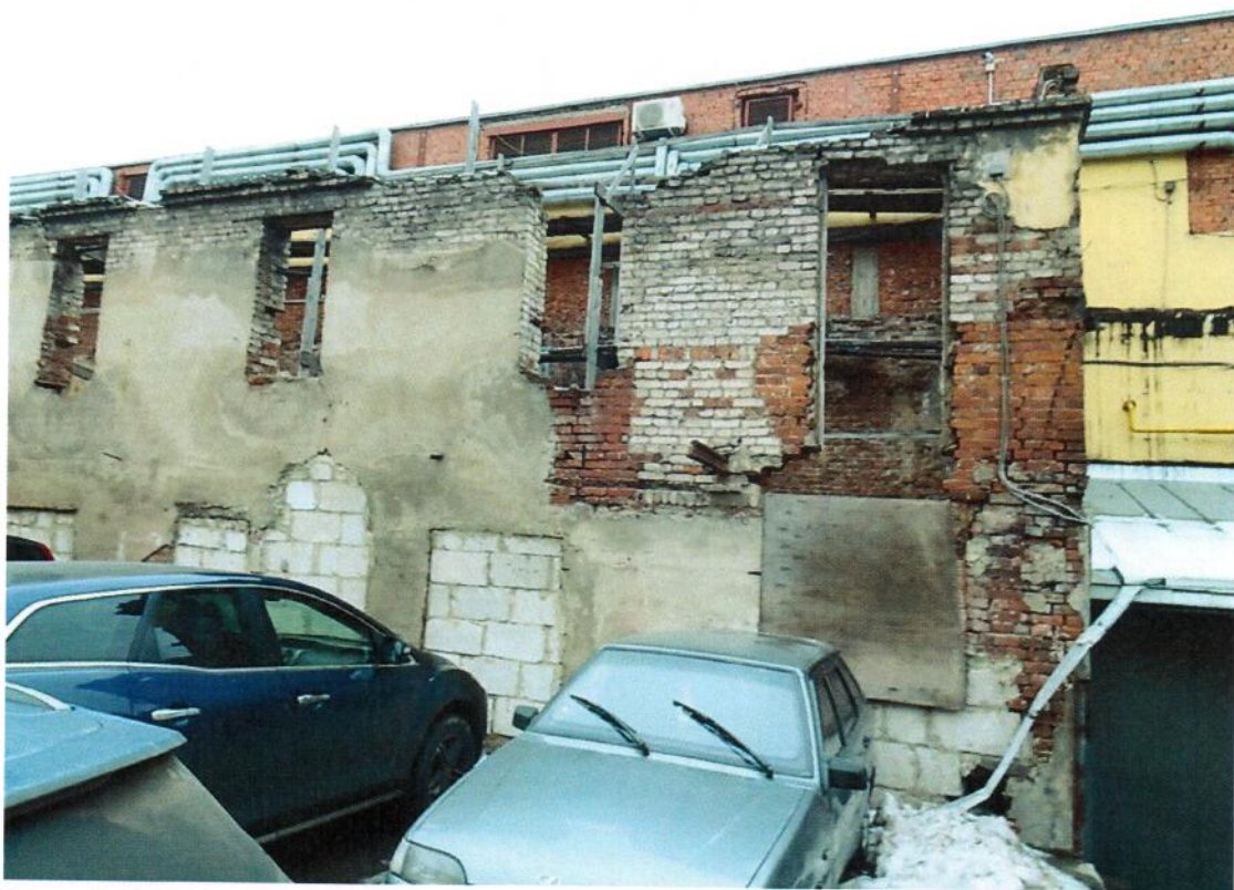
Фото 4. Фрагмент юго-восточного фасада, восточный угол здания, обрушение перемычки, разрушенная верхняя часть стены, вертикальные трещины.
