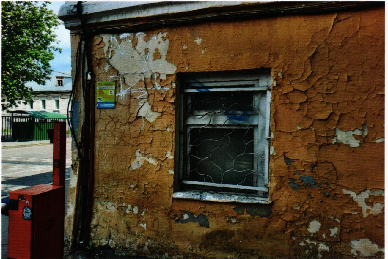
Фото 5. Вид с запада. Боковой асад. Шелушение, вздутие окрасочного слоя.
