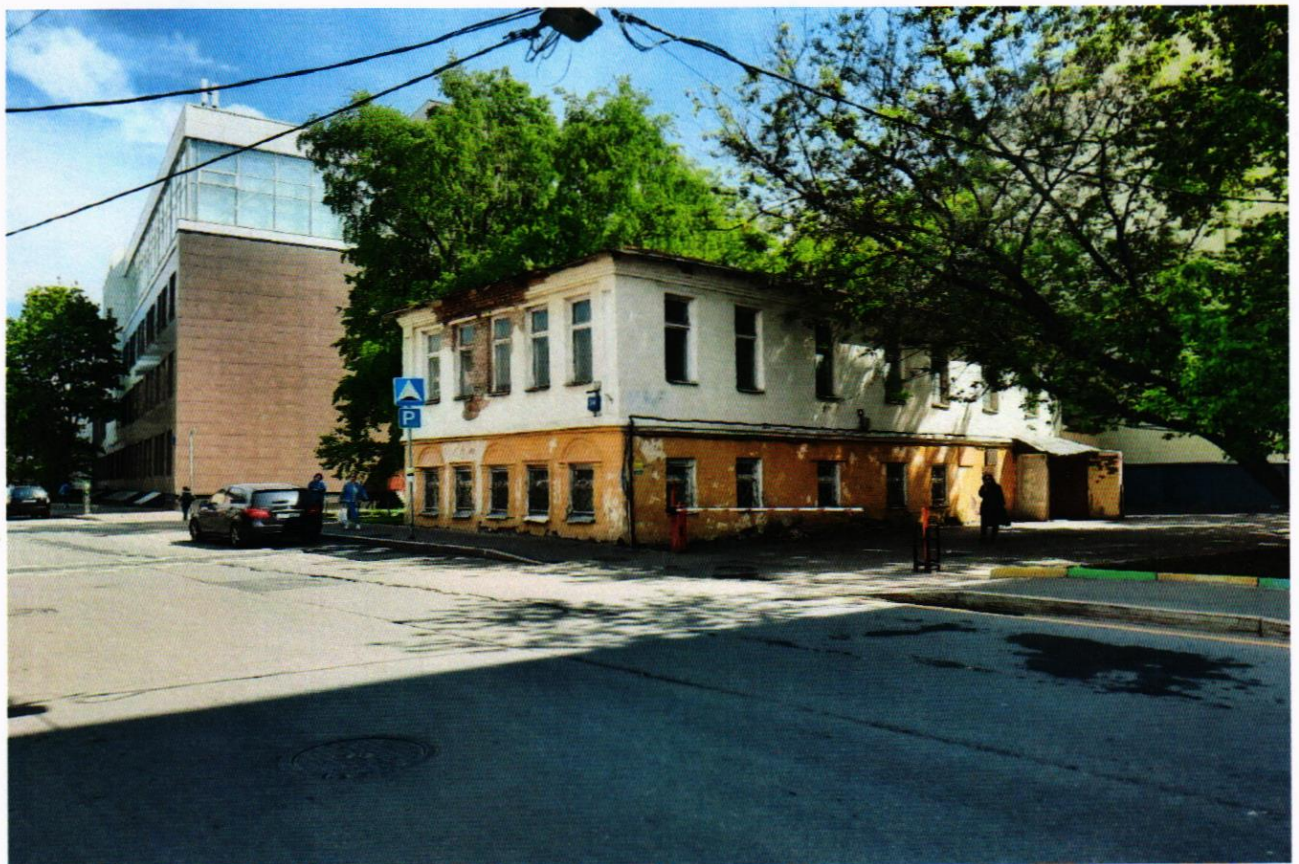
Фото 2. Вид с северо-запада. Боковой протяжённый фасад. Асфальтовая отмотка. Осыпание штукатурного и окрасочного слоёв до кирпичной кладки.
