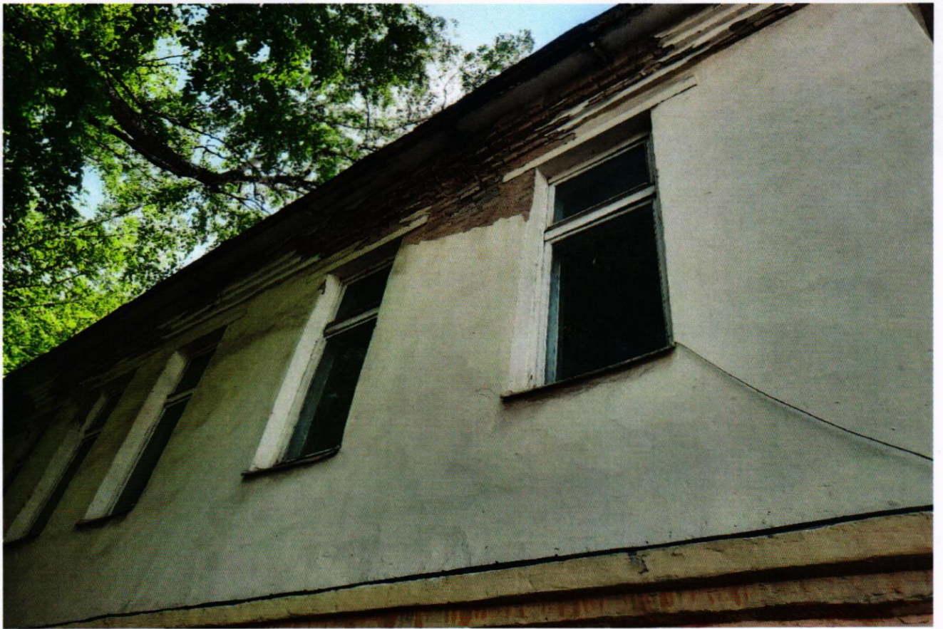
Фото 7. Вид с северо-востока. Боковой фасад. Обрушение профилированного карниза.
