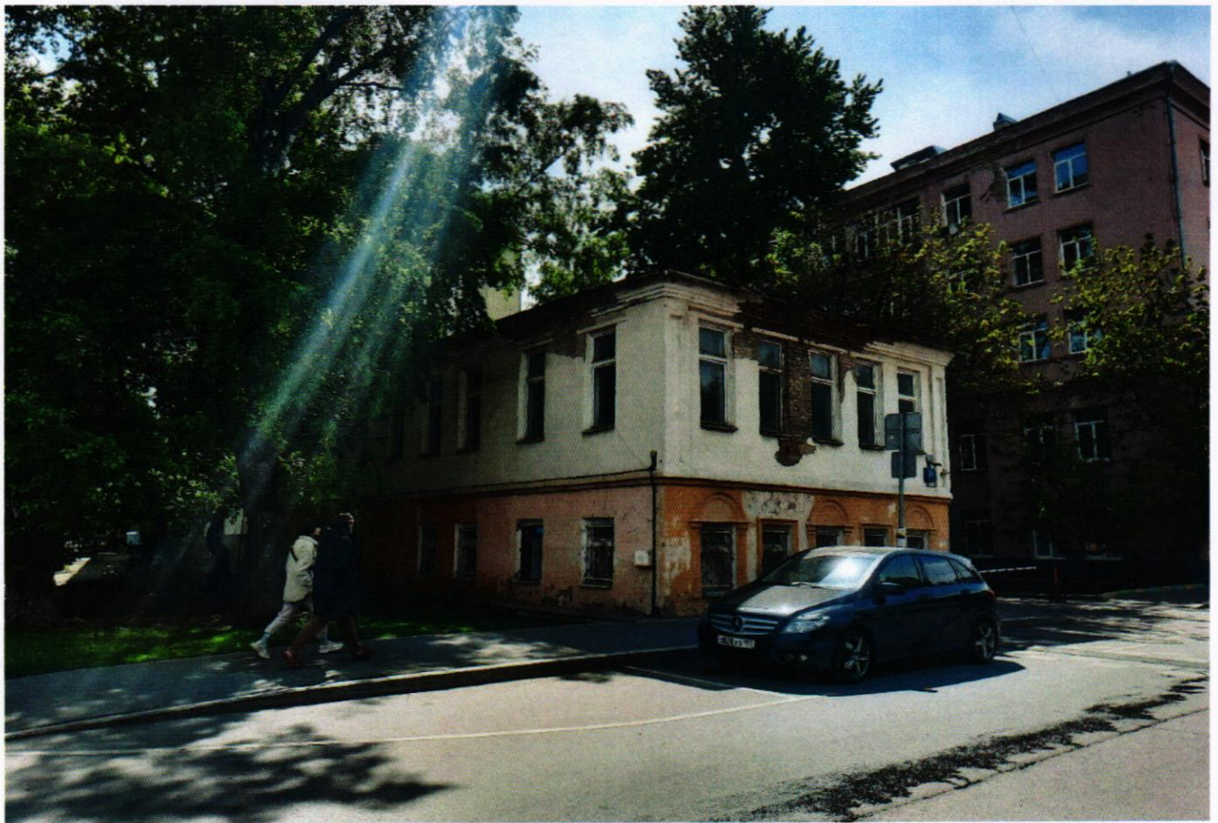
Фото 1. Вид с северо-запада. Главный фасад. Осыпание штукатурного и окрасочного слоя по фасаду.
