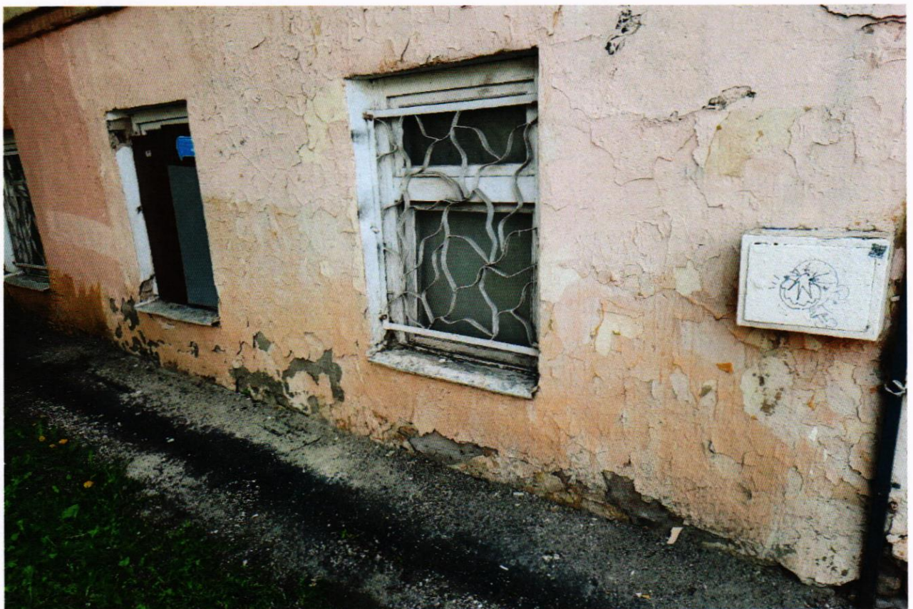
Фото 4. Вид с северо-востока. Боковой фасад. Асфальтовая отмостка. Отслоение штукатурного и окрасочного слоёв до кирпичной кладки.
