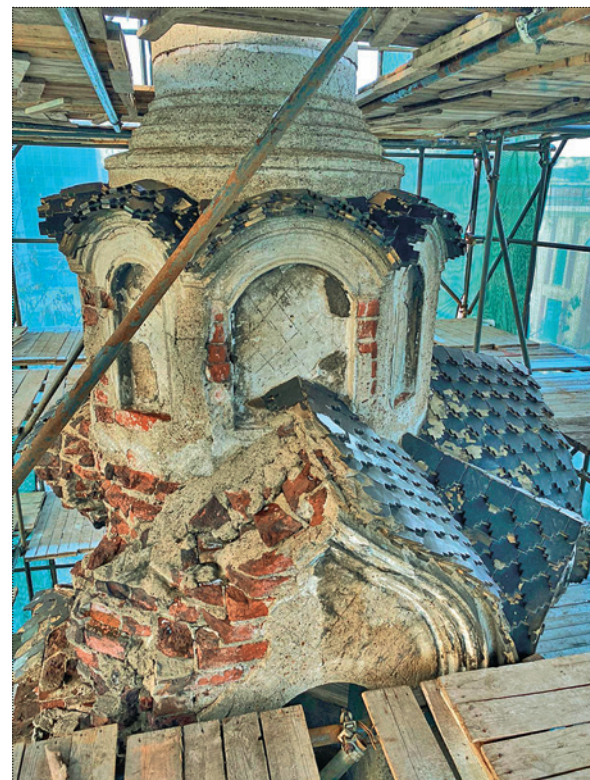
Утраты покрытия из лемеха. Фотофиксация 2022 года
