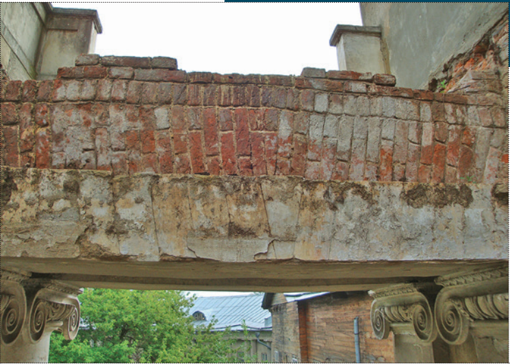
Улица Казакова, д. 18. Несущая архитравная балка левого балкона главного фасада. Фото из архива Г.О. Шарибжановой
